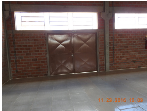
Foto 4 – Nesta imagem observa-se o portão de ferro da entrada, alvenaria, eletrodutos e caixas aparentes, extintor, etc. (Centro Multiuso Nova União)
