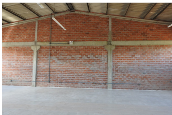
Foto 3 – Nesta imagem é possível observar as caixas e eletrodutos aparentes (Centro Multiuso Nova União)
