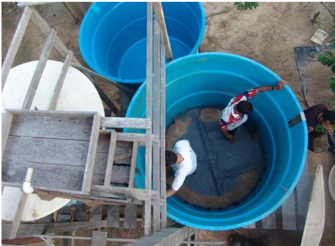
Figura 9: Exemplo de filtro lento de areia construído com caixa de 5.000 litros.
